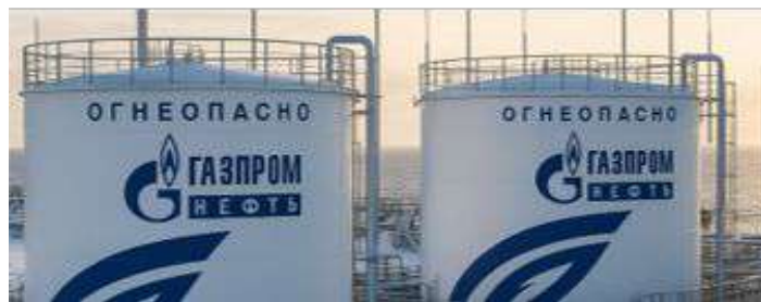
Резервуарный парк для хранения сырой нефти Омская обл.
