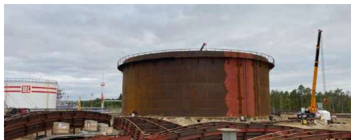
Резервуарный парк 5 000 м 3 Пермский край.
